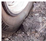
ناهمواری شدید در سطح جاده
